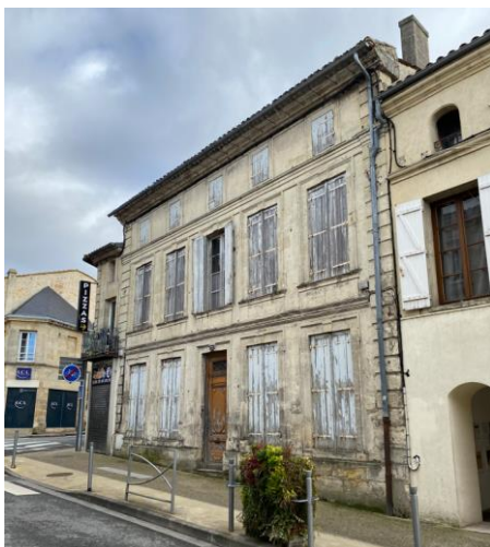
Façade dégradée // crédit photo MERC/AT
